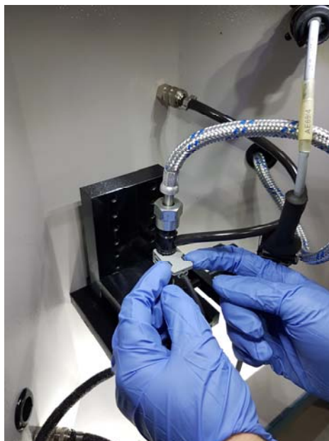
Figura 4.12 Scollegamento del cavo elettrico
